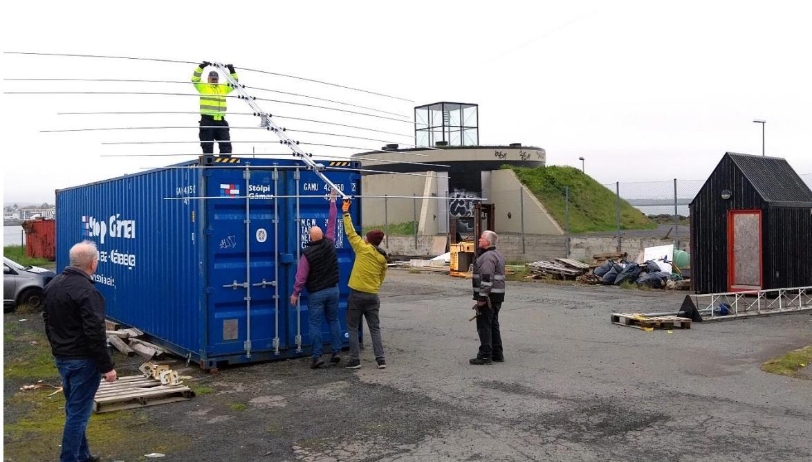
Fullsamsettu loftneti komið fyrir uppi á bláa gámnum þar sem að verður geymt þar til kemur að uppsetningu.
