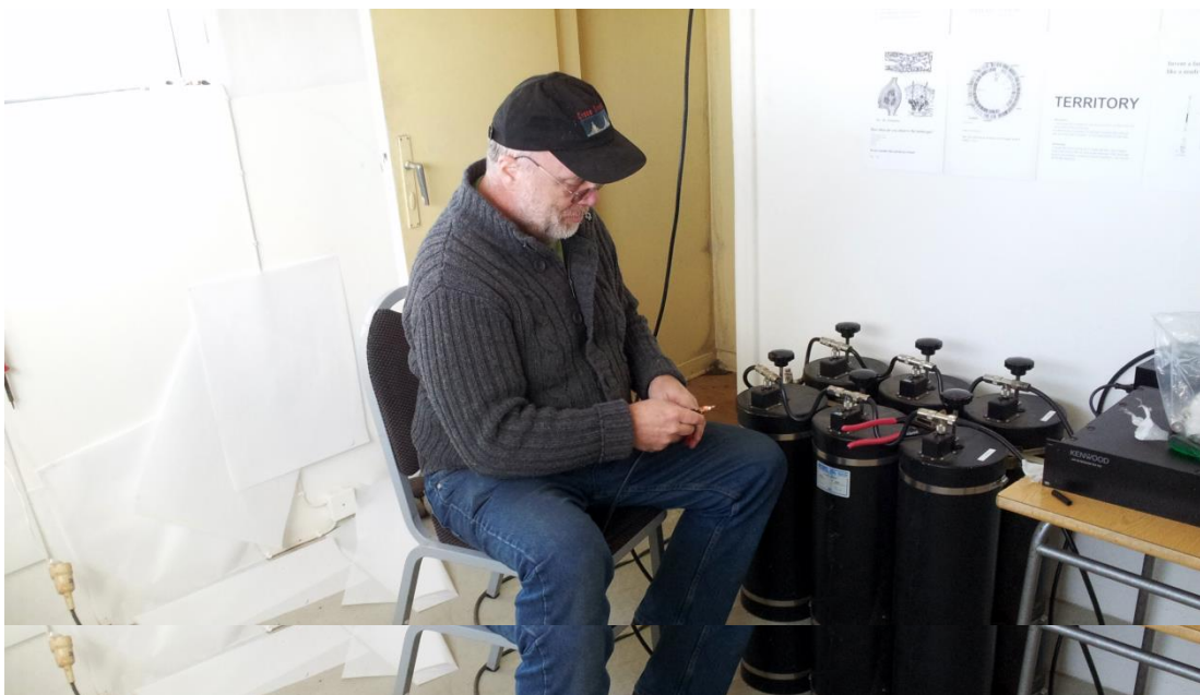
Ari gengur frá tengingu Kenwood TKR-750 við "Cavity" síurnar sex frá Decibel Products. Ljósmynd: TF8SM.
