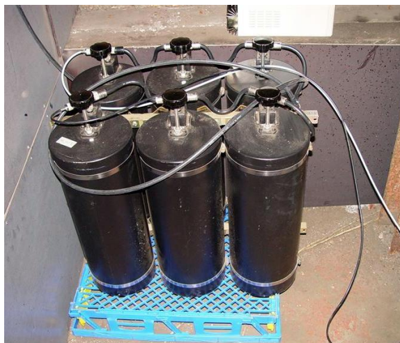
„Cavity“ síurnar við TF3RPC. Í bakgrunni má sjá í aflgjafann fyrir endurvarpann. Ljósmynd: Sigurður Harðarson TF3WS.
