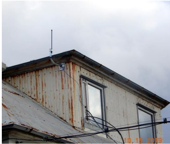
Flugradar loftnetið komið upp og allt virkar vel. Myndir: TF3JB.
