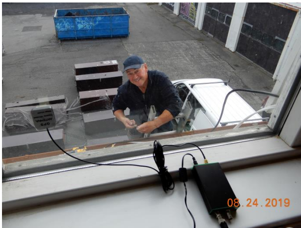
23. ágúst. Nýja fæðillínan kominn inn í fjarskiptaerbergið. Georg Kulp TF3GZ festir niður og gengur frá kaplinum. Ljósmynd: TF3JB
