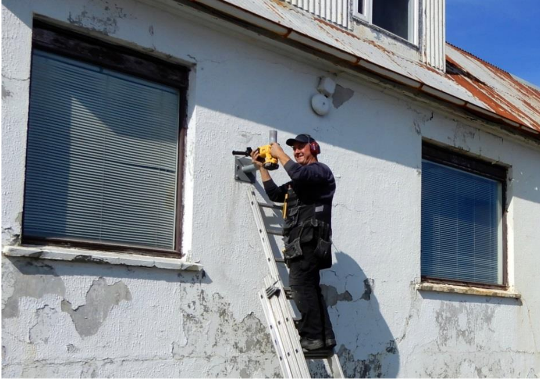
TF3GZ setur upp sandblásna og zinkhúðaða veggfestingu á austurvegg hússins. Ljósmynd: TF3JB.
